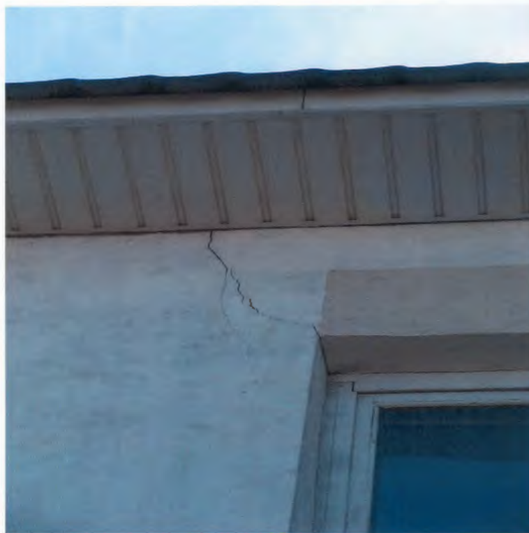
Рисунок 4.3.5.1.1 – Трещина над оконным проемом в уровне 2-го этажа
